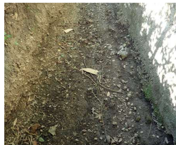
Granulométrie graviers déchaussement – sous cavement (SEGMENT AVAL)
